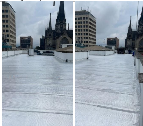
(B) Posterior al arreglo no se puede continuar operación hasta gestionar adecuadamente las nuevas adecuaciones.
